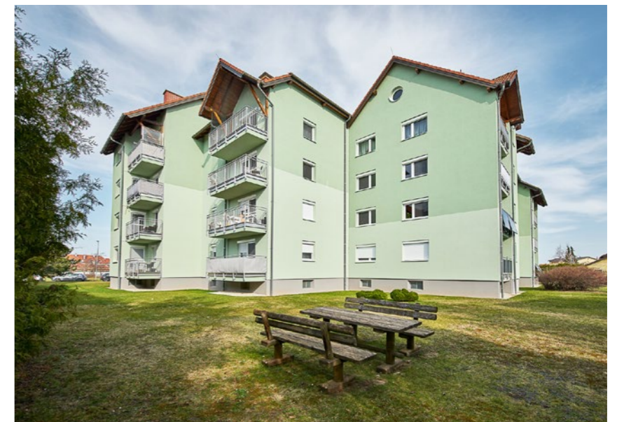
Ebenfalls in Neunkirchen wurden in der Grünlandgasse 3 und 5 neue Fenster und Balkontüren mit Außenrollläden eingebaut und eine umfassende Neudämmung sowie ein Fernwärmeanschluss vorgenommen.
