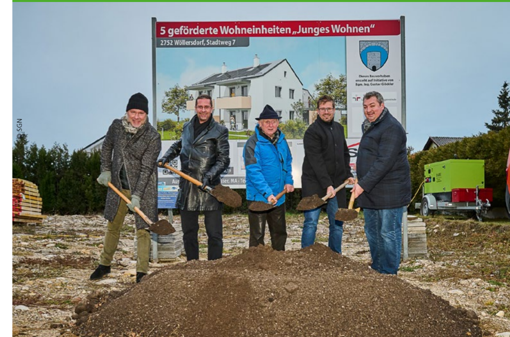
In Wöllersdorf-Steinabrückl errichtet die SG Neunkirchen 5 Wohnungen für Junges Wohnen. Im Dezember wurde der Bau durch den damaligen Bgm. Ing. Gustav Glöckler, VBgm Hubert Mohl, Arch. DI Gottfried Markom und SGN-Vorstandsobmann KommRat Martin Weber, MSc, mit einem Spatenstich gestartet.
